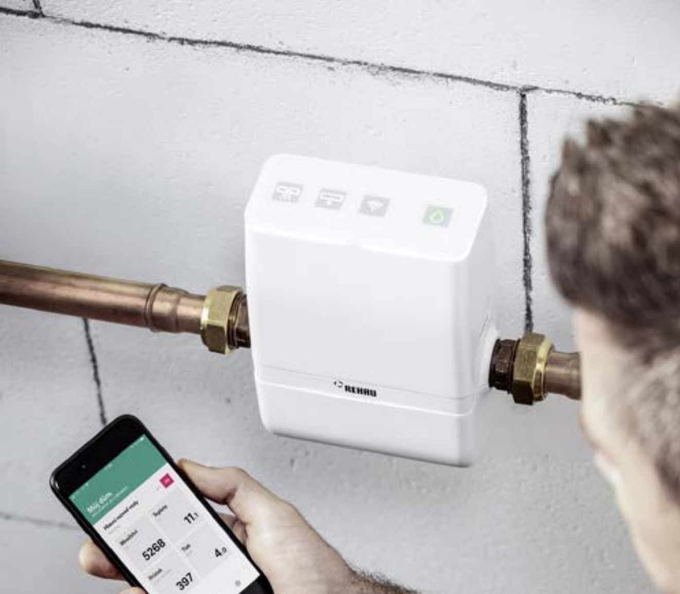
RE.GUARD jednoduše můžete ovládat na dálku pomocí mobilního telefonu
