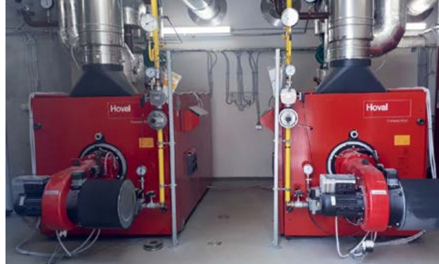
Vyšší spotřeba pro vytápění je kompenzována kondenzačními plynovými kotli
