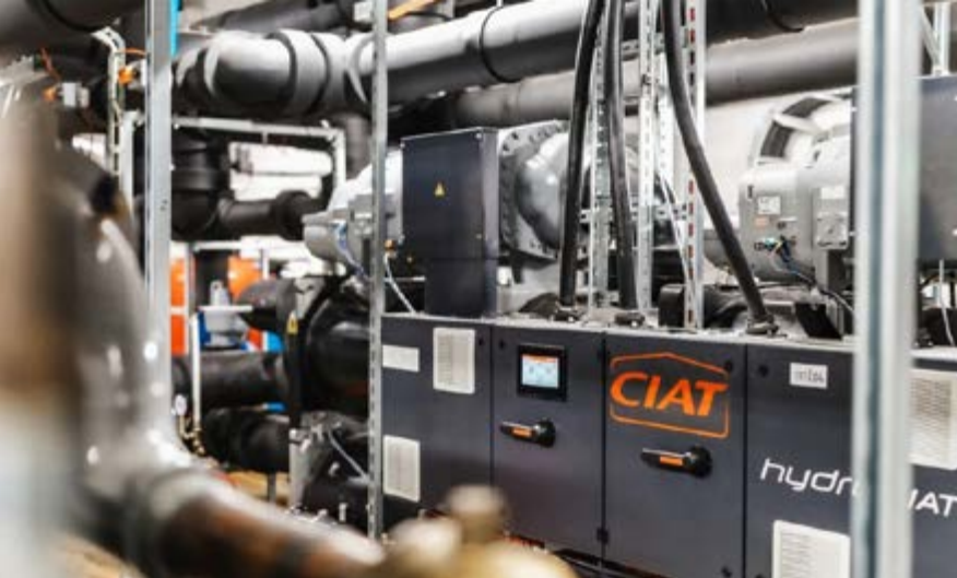
Hlavním zdrojem vytápění a chlazení jsou tepelná čerpadla voda–voda
