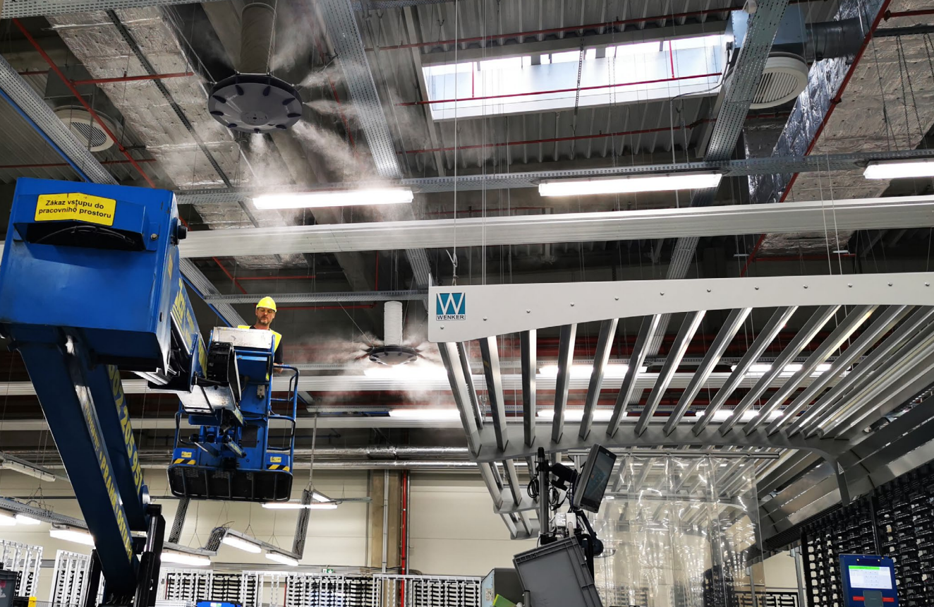
Destratifikátory Merlin Technology, instalované u stropu hal, zabraňují vrstvení horkého vzduchu v provozech
