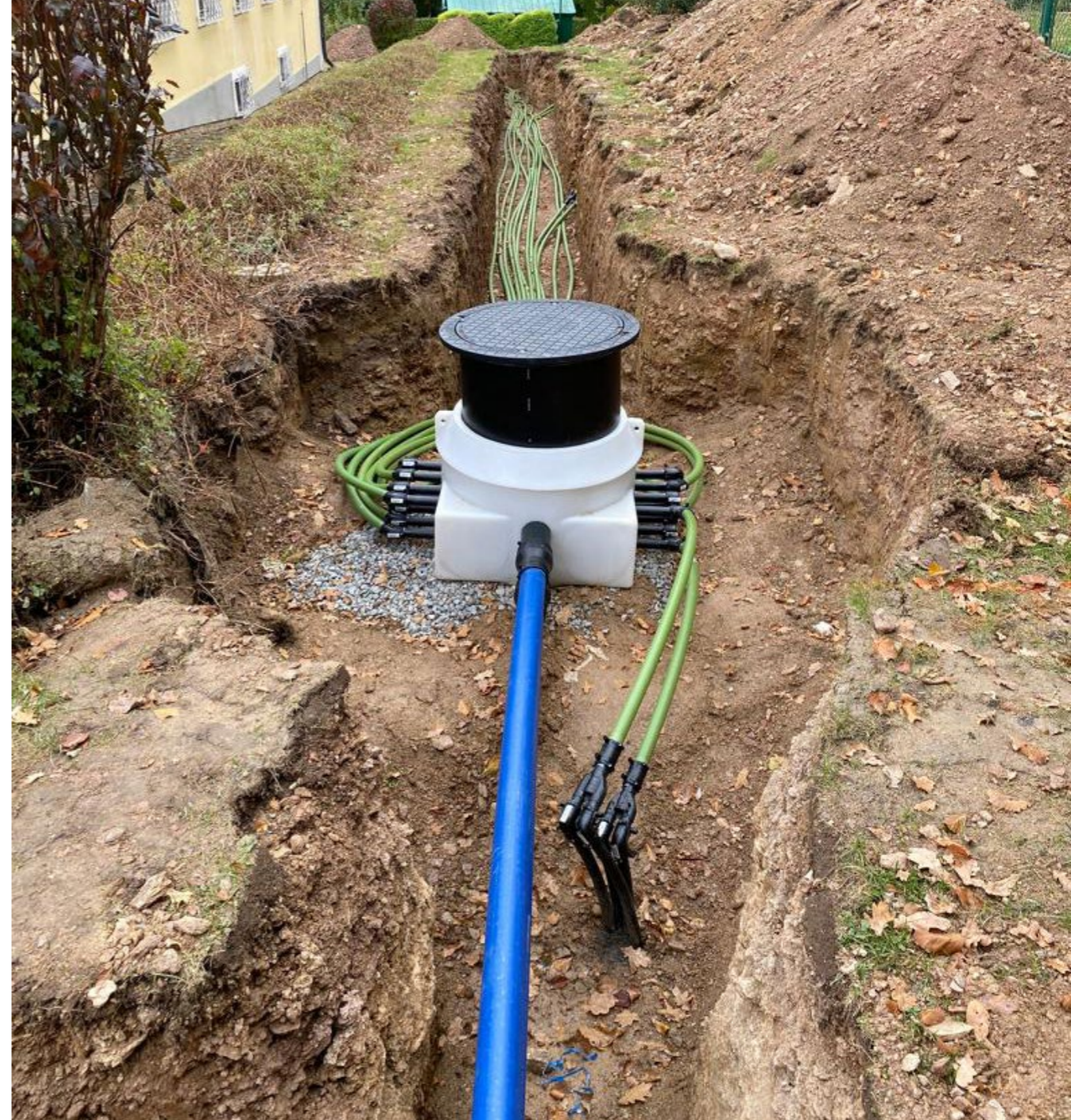
Sběrná jímka pro vrtné pole a páteřní vedení do objektu
