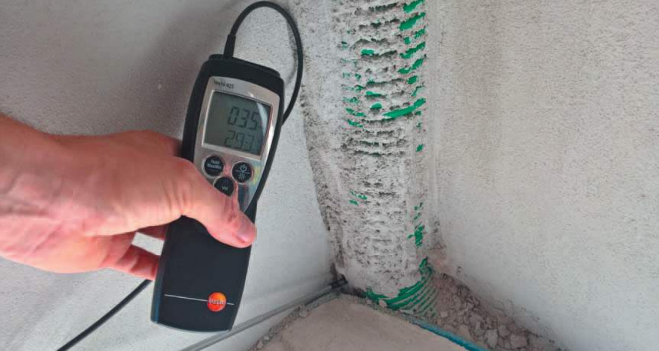
Problematické místo napojení příčky na obvodou stěnu v místě instalace průchodů u hrubé podlahy
