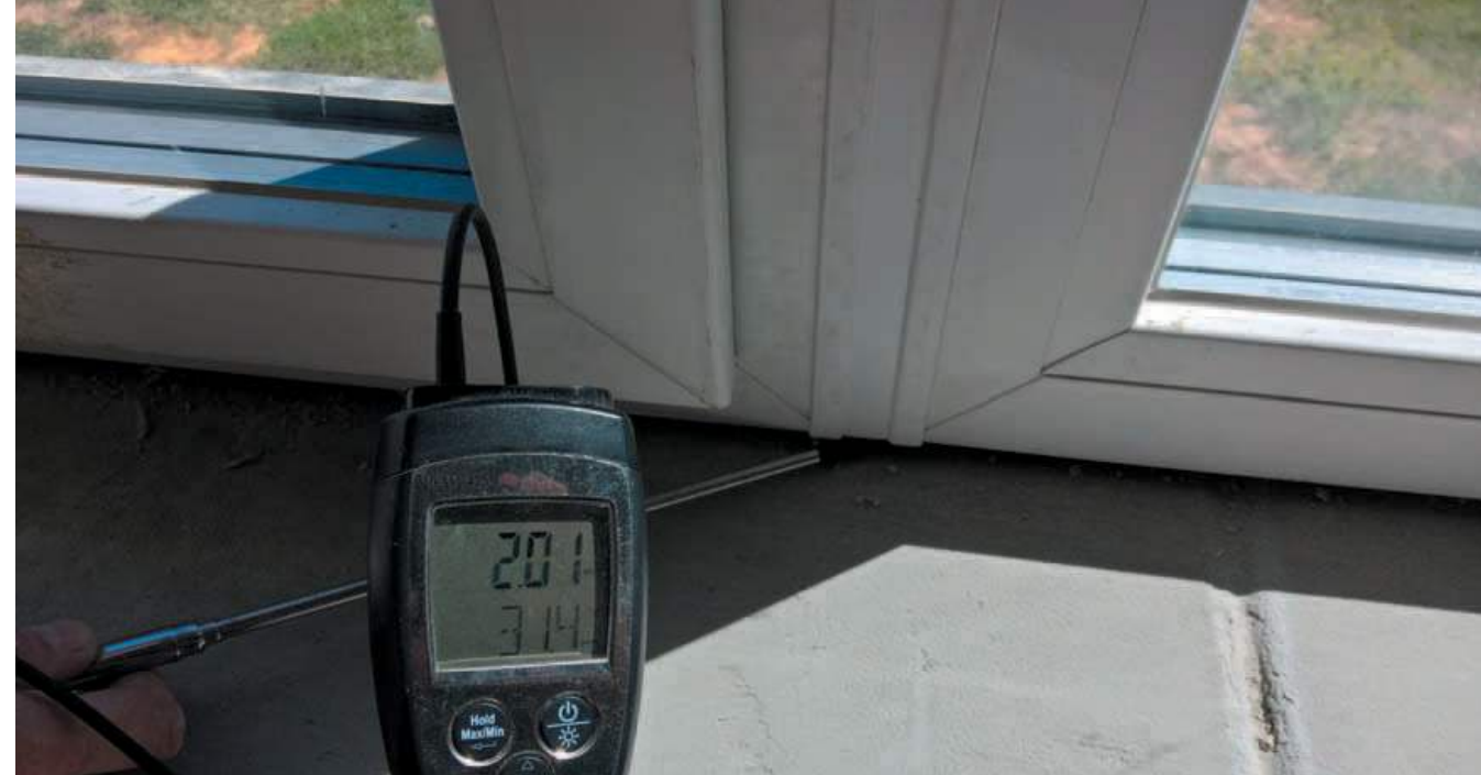
Výrazné proudění vzduchu ve špatně utěsněném místě styku okenního rámu a parapetu
