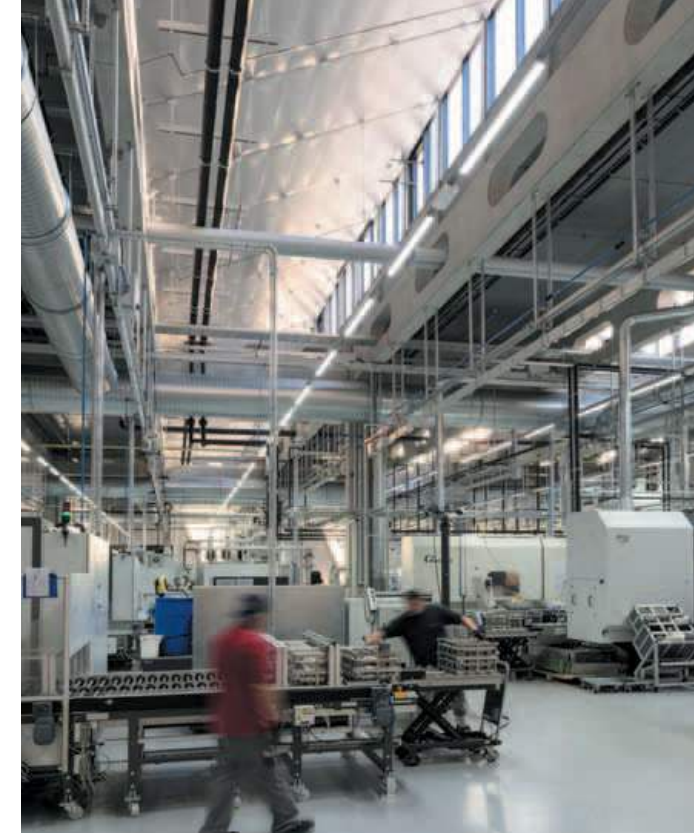
Přibližně 18 % osvětlení hal zajišťuje denní světlo, zbytek je doplněn výhradně úspornými LED svítidly.
