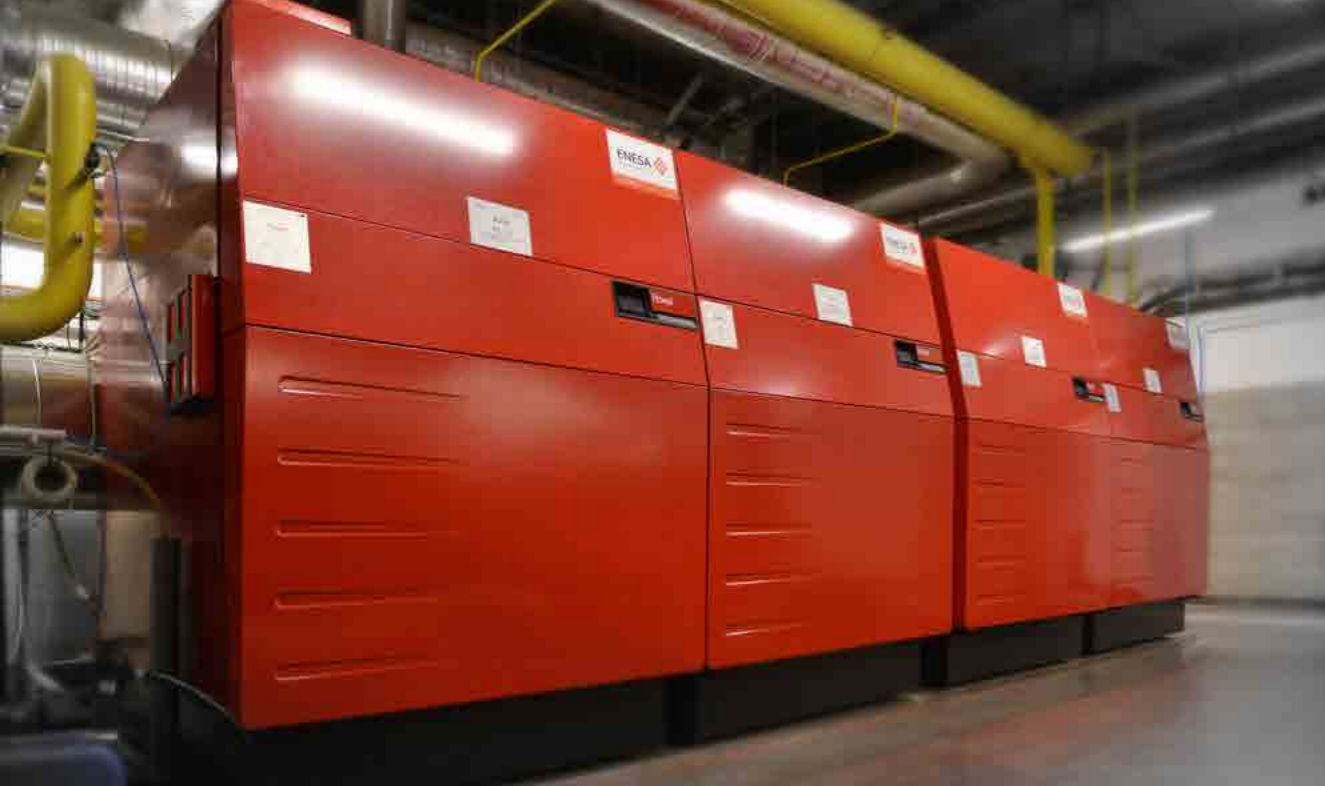
Instalované plynové kondenzační kotle Hoval UltraGas.
