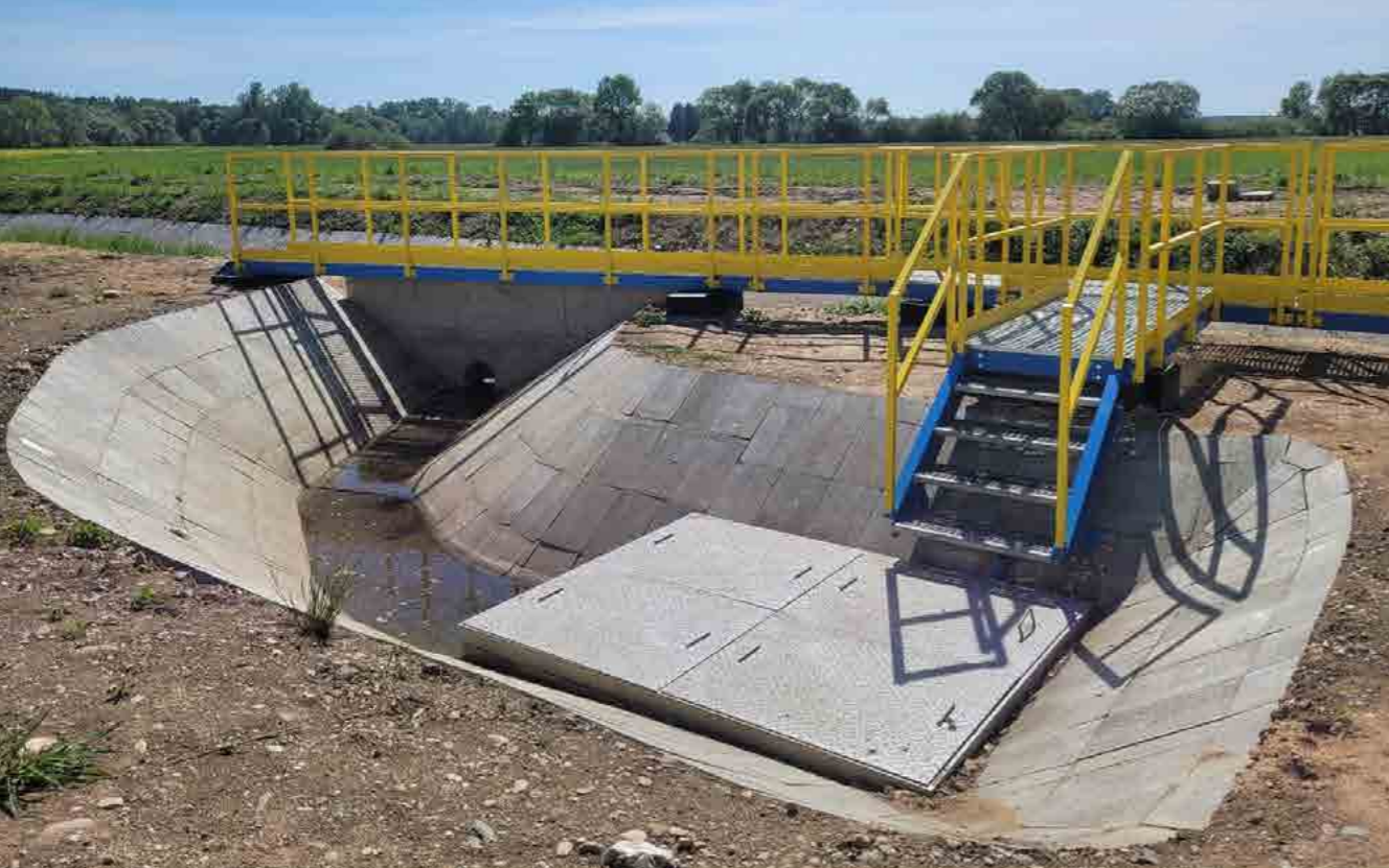
Nádrž na sběr dešťové vody v závodě Isover v Častolovicích.
