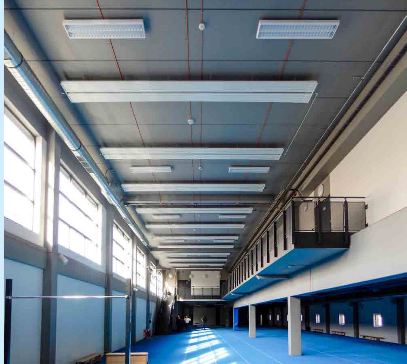
Stropní sálavé panely pro vytápění a chlazení ve sportovní hale v Táboře.
